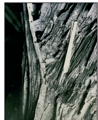
Figure 12 : Déformation des schistes ardoisiers dans la galerie d'amenée en charge Lanoux-l'Hospitalet, au-delà de 300 m de couverture.
