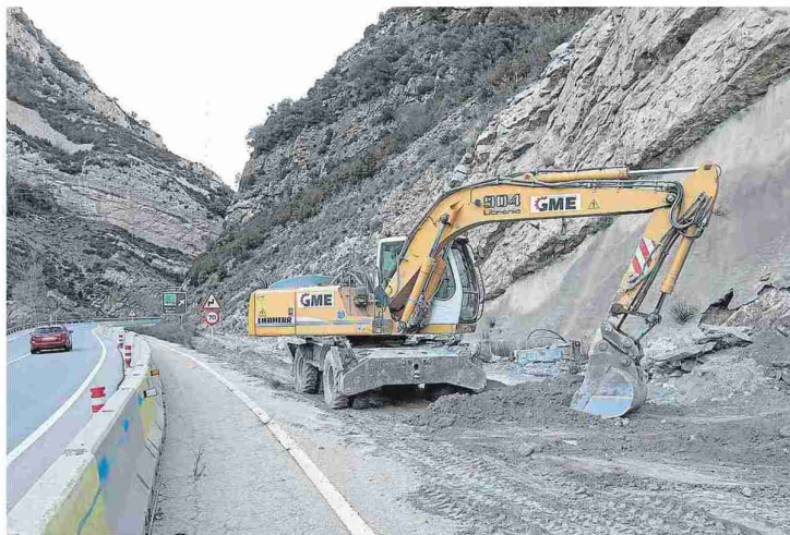
Una retroexcavadora prepara el acceso para iniciar las obras en paralelo a la N-330. RAFAEL GOBANTES
